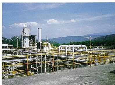
二本木工場 活性汚泥施設
