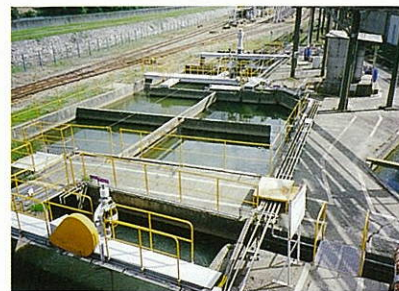
高岡工場 1号排水処理設備
