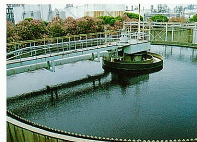
千葉工場 排水処理沈殿槽
