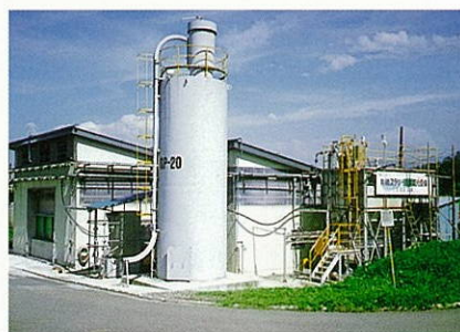
二本木工場 無機スラッジの再資源化施設
