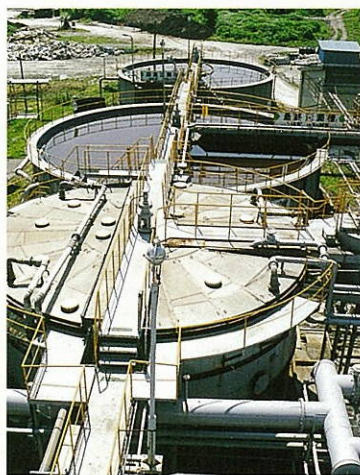
二本木工場 活性汚泥施設
