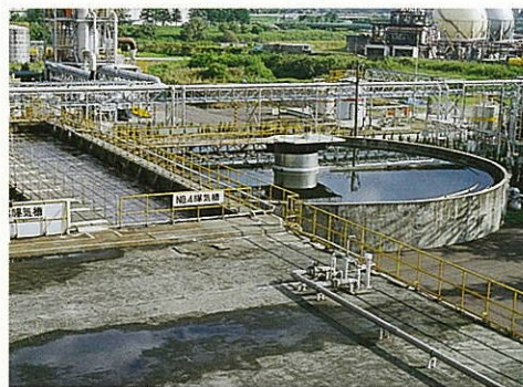
高岡工場 活性汚泥施設
