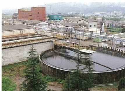
高岡工場 活性汚泥施設
