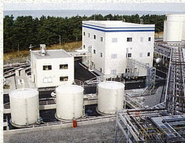
北陸電力株式会社絶縁油リサイクルセンター
