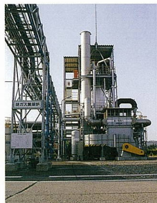
高岡工場 排ガス焼却炉
