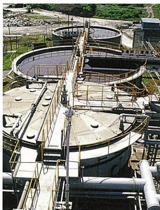
二本木工場 活性汚泥施設
