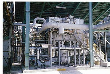
二本木工場 脱臭炉
