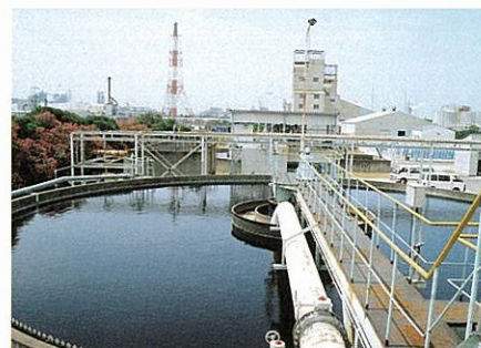
千葉工場 排水処理沈殿槽
