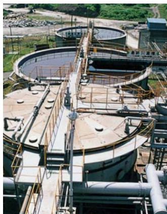
二本木工場 活性汚泥施設
