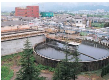
高岡工場 活性汚泥施設
