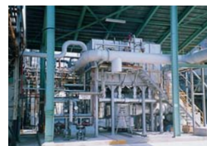
二本木工場 脱臭炉
