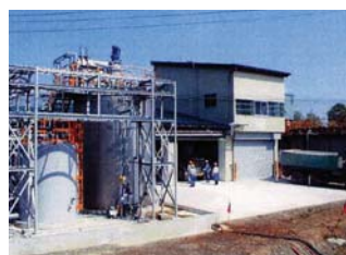
二本木工場 ろ過石灰石製造プラント
