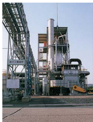
高岡工場 排ガス焼却炉
