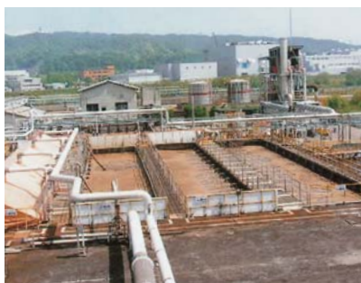
高岡工場 活性汚泥施設
