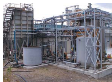
二本木工場 ろ過石灰設備
