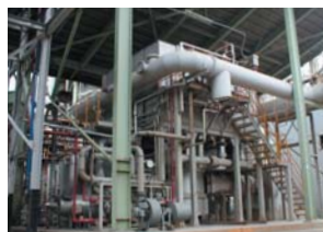
二本木工場 脱臭炉
