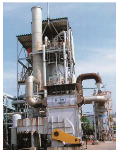
高岡工場 排ガス焼却炉
