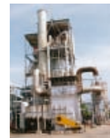
高岡工場 排ガス焼却炉 有害物を含む排ガスを焼却する設備です。
