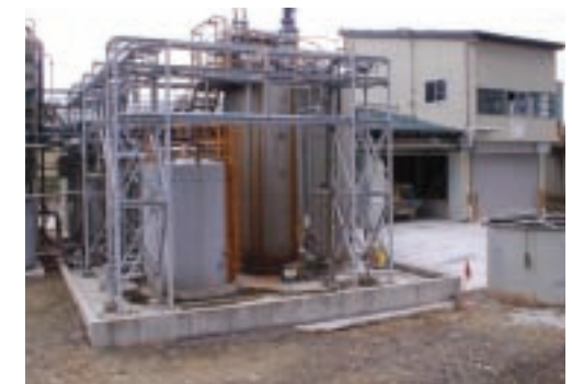
二本木工場 ろ過石灰設備 工程で発生する石灰質スラッジをセメント原料化する設備です。
