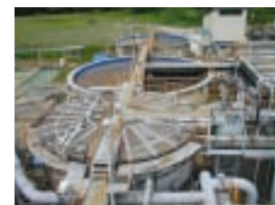
二本木工場 活性汚泥沈殿槽
