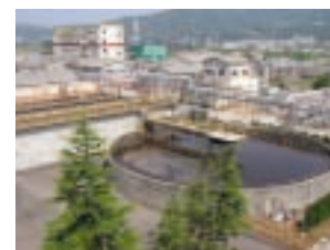
高岡工場 活性汚泥設備
