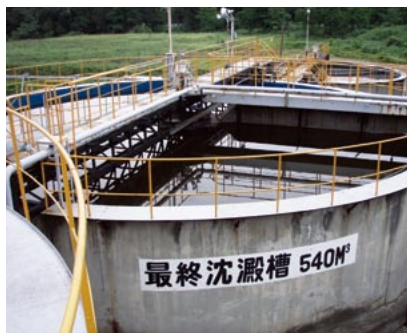
二本木工場 活性汚泥沈殿槽
