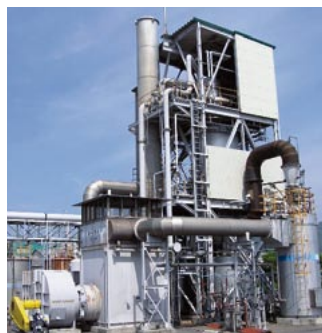
高岡工場 排ガス燃焼炉 有害物を含む排ガスを焼却する設備
