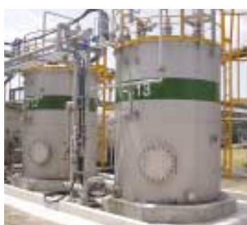
曝気槽(高岡工場)
