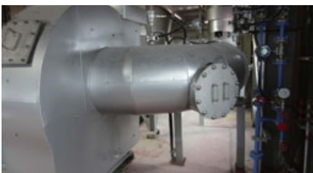
対策後に点検口が追加された排ガス配管とブロワ
